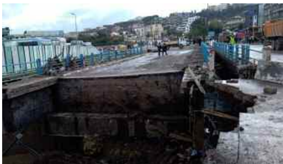
Les inondations ont causé des dégâts considérables dans la wilaya de Jijel. (Photo : D.R)
