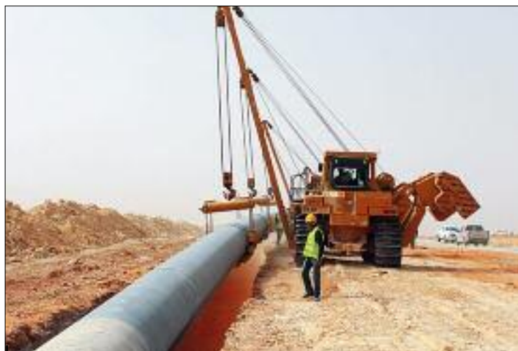
■ L'Italie est actuellement approvisionnée via le gazoduc TransMed, tandis que le Medgaz assure la totalité de l'approvisionnement en GN de l'Espagne. (Ph. : DR)
